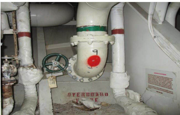
Pipes in ER
